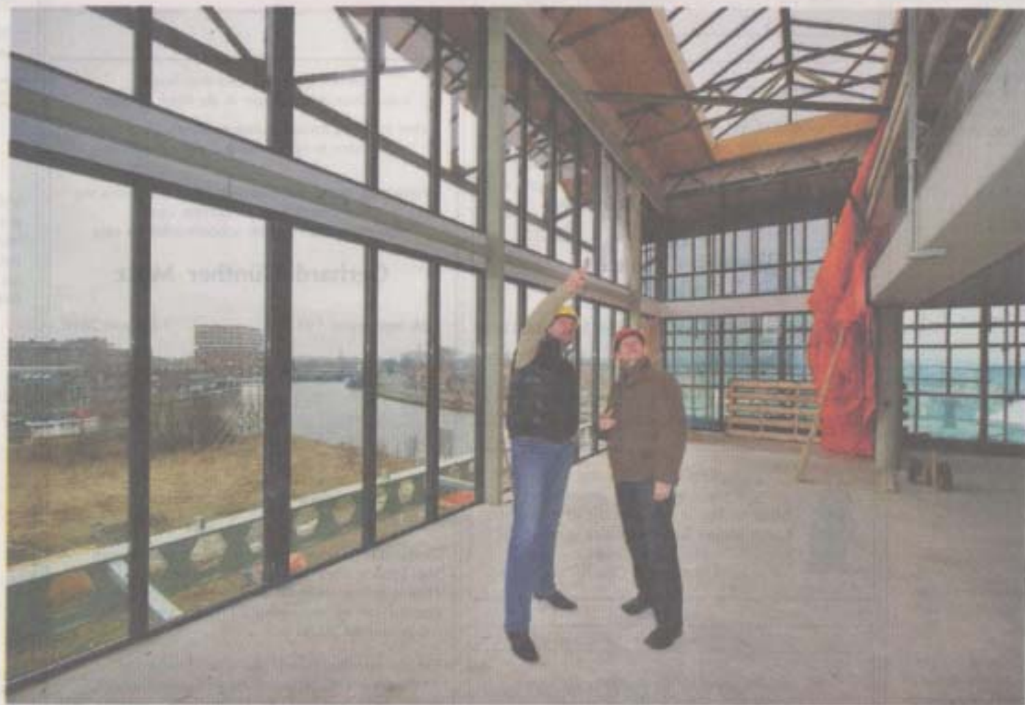
Projectontwikkelaar Willem Groos (links) overlegt met Regiobouwdirecteur Ed van Stein. Op de achtergrond een prachtig panorama van Spaarne en de oude stad.
